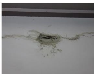
構造体のひび割れ
