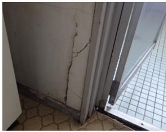
内壁のひび割れ
