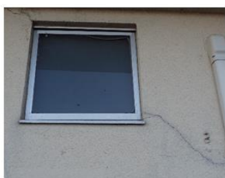
外壁のひび割れ
