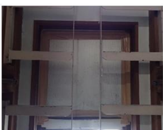
隙間風が生じる建具 (テープで隙間補修)
