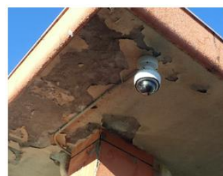
軒裏のモルタルの剥落
