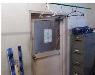
建具の開閉不良
