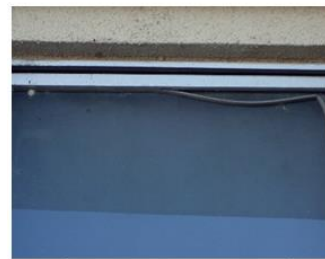
建具のシーリング劣化
