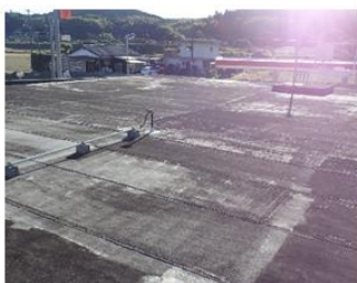
屋上防水の劣化
