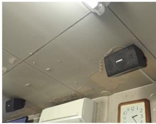
天井材の劣化
