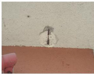
軒裏の鉄筋露出
