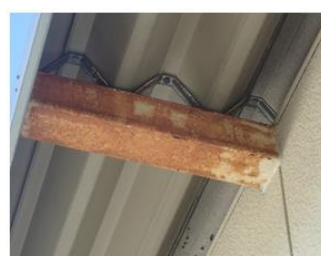
車庫棟鉄骨梁の錆
