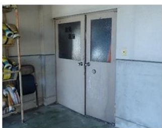
建具の開閉不良
