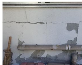
外壁のモルタルの剥落
