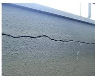
壁のひび割れ
